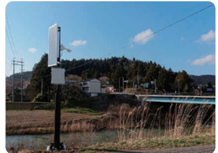
河川カメラの設置状況
